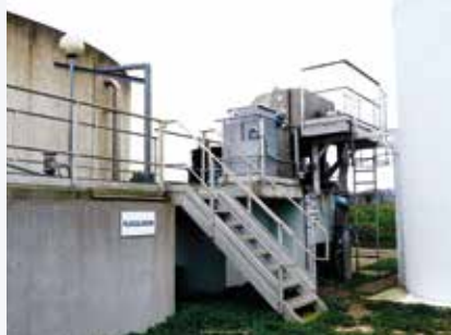
Les eaux usées à traiter
